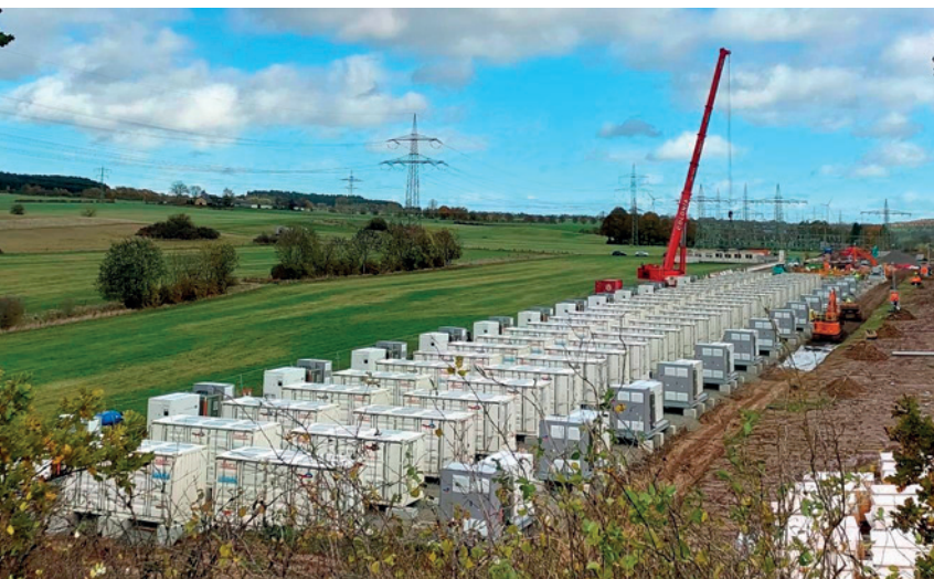
Projet de stockage d'énergie par batteries de Kyon Energy à Dahlem, octobre 2025. © Saft
