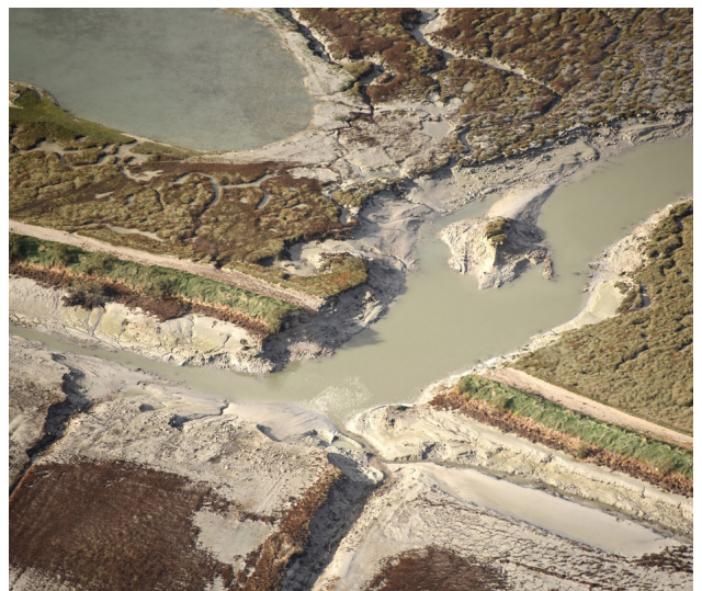
Sentier littoral interrompu par une brèche sur la digue, baie de Lancieux, Côtes d'Armor (c) Erwan Le Cornec / Géos-AES
