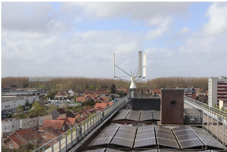
Toiture solaire de l'hôtel d'agglomération, Béthune (c) Laurence Renard - La Fabrique du Lieu
