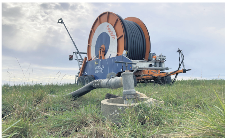
Une station de pompage distribue les eaux vers les terres via un réseau enfoui de trois kilomètres. (Photo NR, J.P.)
