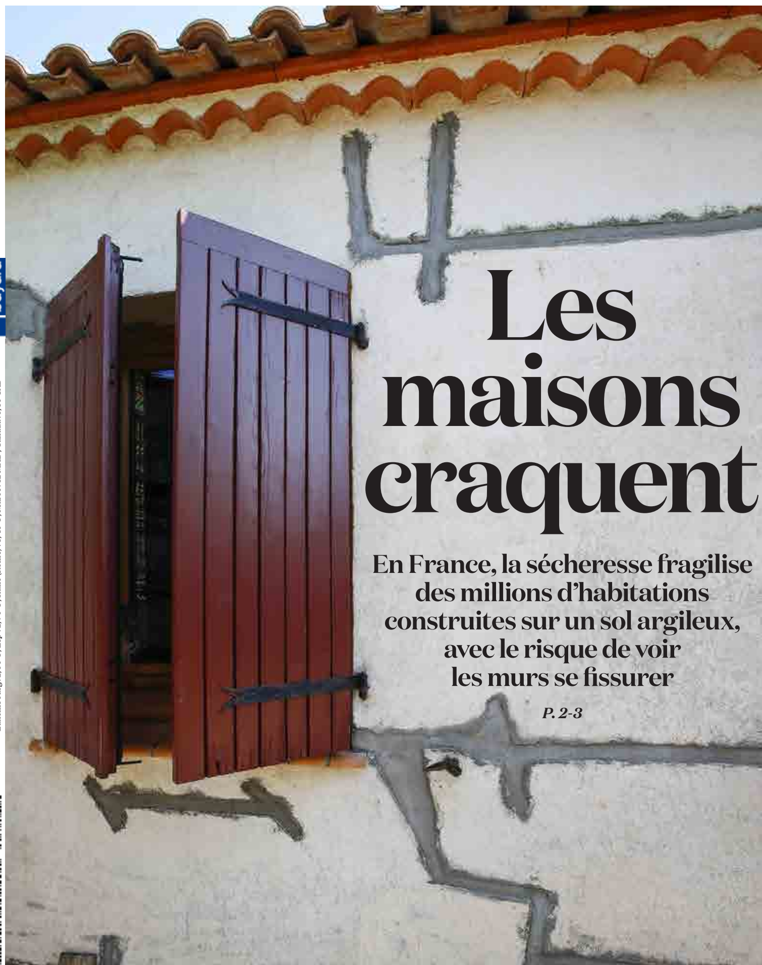
Maison fissurée chez une habitante de Villeneuve-lès-Maguelone, près de Montpellier (Hérault), le 15 août. Alain Tendero/Divergence pour La Croix
